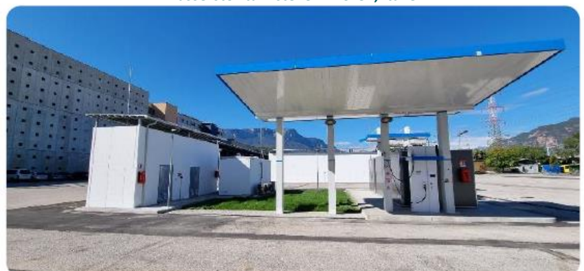
Wasserstofftankstelle in Bozen, Italien
