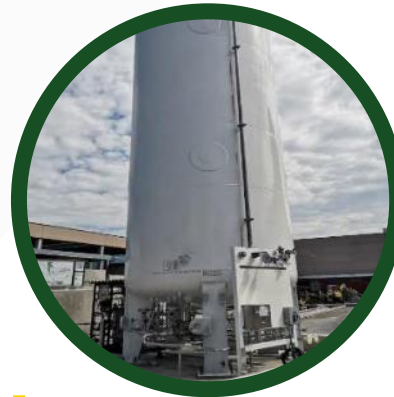
LNG Refueling Station
